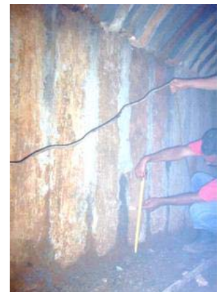
Figura 1 Se indica el nivel alcanzado por el agua producto a una inundación parcial en el túnel 1
