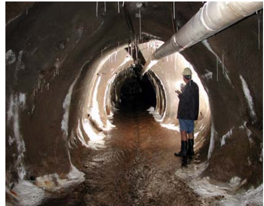
Figura 3. Galería de drenaje en explotación de carbón
