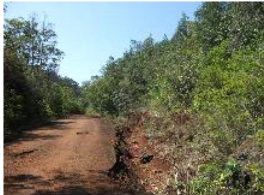
Figura 4.9 Procesos erosivos afectando el Vial en el punto de documentación No. 8.
