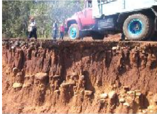
Figura 4.7 Afectación del vial por erosión y socavación.
