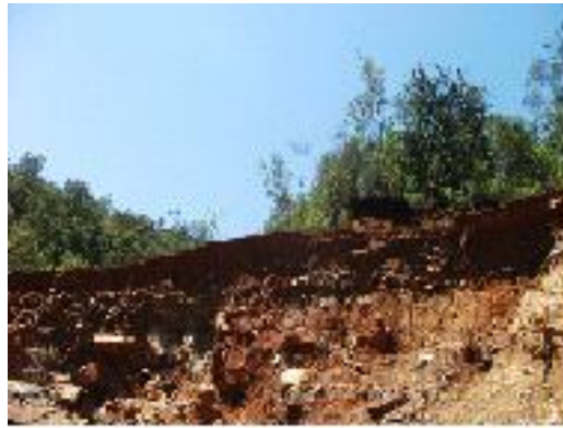
Figura 4.6 Afectación del vial por erosión.
