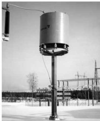
Figura 3.6 Reactor con núcleo de aire para puesta a tierra.
