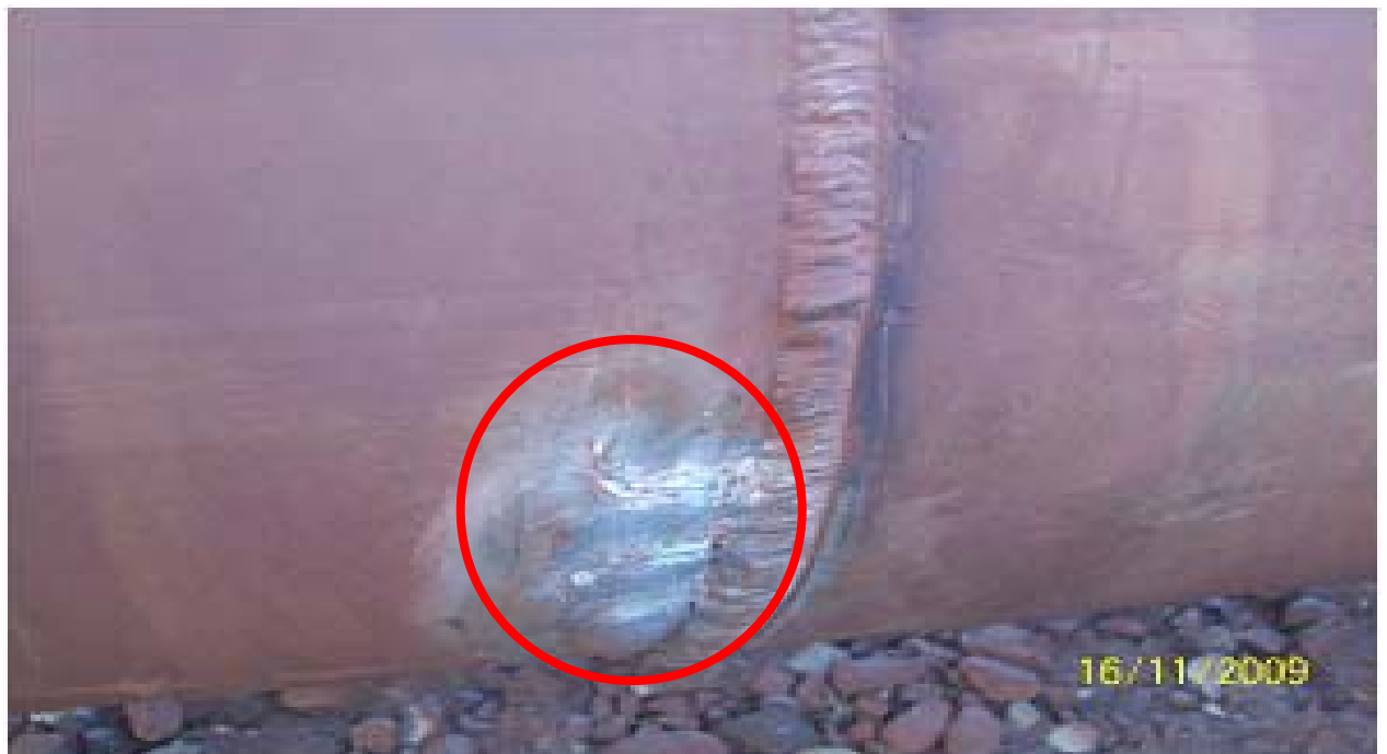
Figura 2. Área de la zona de soldadura afectada.
