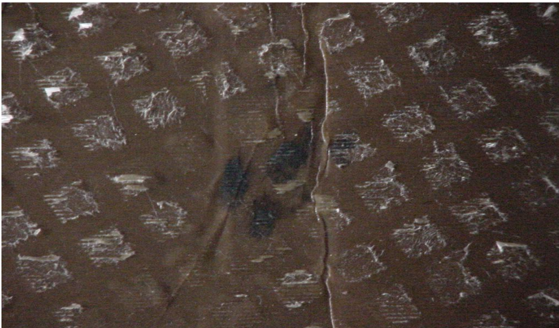
Figura 1.2: Daños en el papel aislante de un transformador de distribución por causa de sobretensiones.
