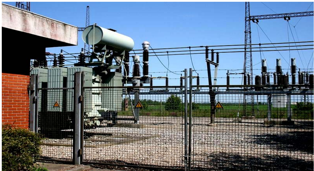
Figura 1.3 Transformadores trifásicos de potencia.
