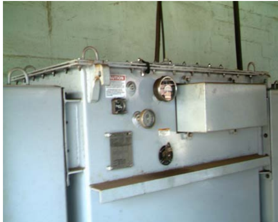
TRANSFORMADOR ELEVADOR (0.48/1.16KV)
