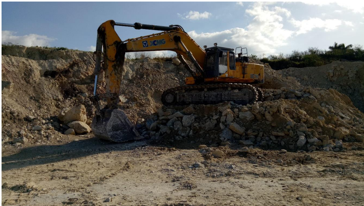
Figura N°3. Retro excavadora en el frente de arranque de la cantera Victoria II
