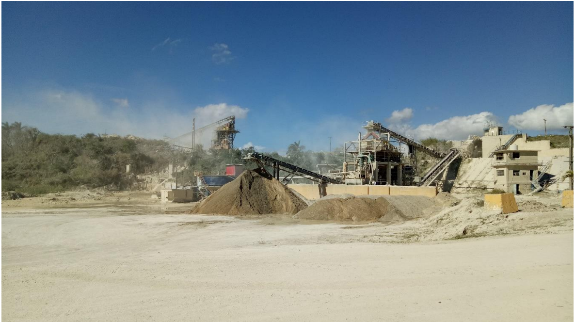
Figura N°5. Planta de procesamiento Victoria II.
